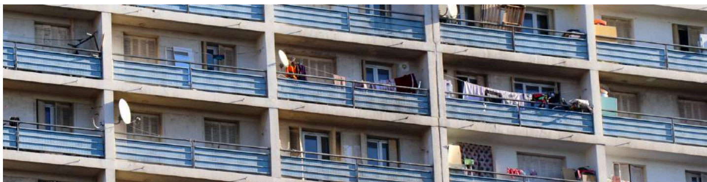
Barre d'immeuble d'une copropriété dégradée. ©Hortense Gauthier
